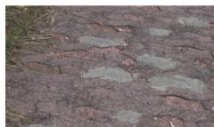
Abb. 1 Lächeriger Zustand des Fuß-/Radweges zwischen Wambach und Bärstadt. Manche Stellen wurden bereits früher ausgebessert.
